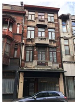
C. Necessitat de manteniment
