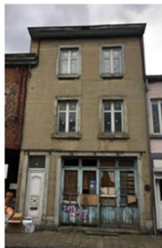
B. Necessitat d'una gran renovació
